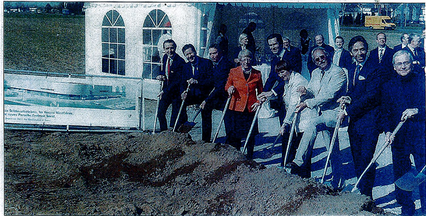
Bei Kaiserwetter wurde gestern der Spaten zum Baustart des Porschezentrums zehnfach angesetzt (von links): Dr. Rudolf Rizzolli (Geschäftsführer Enbrocks (Porsche)), Wolfgang Lüning (Leiter Porschezentrum Soest), Vizebürgermeisterin Christiane Mackensen, Ralf Kreuzberg, Ingrid Hülpert, Peter Hupler (alle Hülpert-Gruppe), Projektleiter Dieter Schädel und Peter Lüdemann (Porsche). ■ Foto: Fischer
